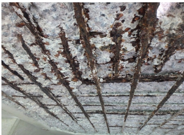
Korroderet armering på US brodæk.
