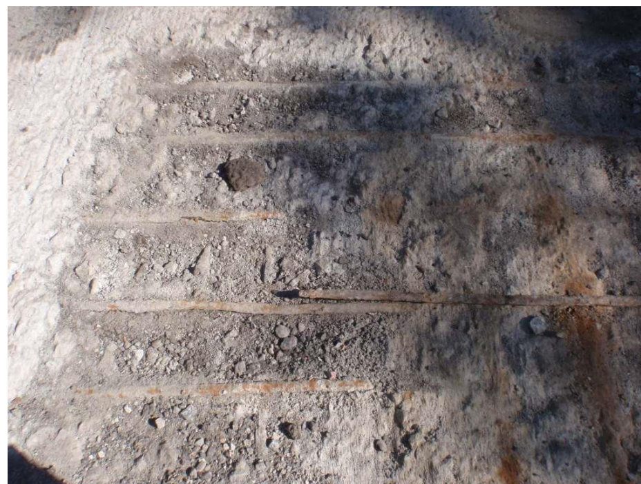
Dog enkelte områder med dårlig beton og korroderet armering.
