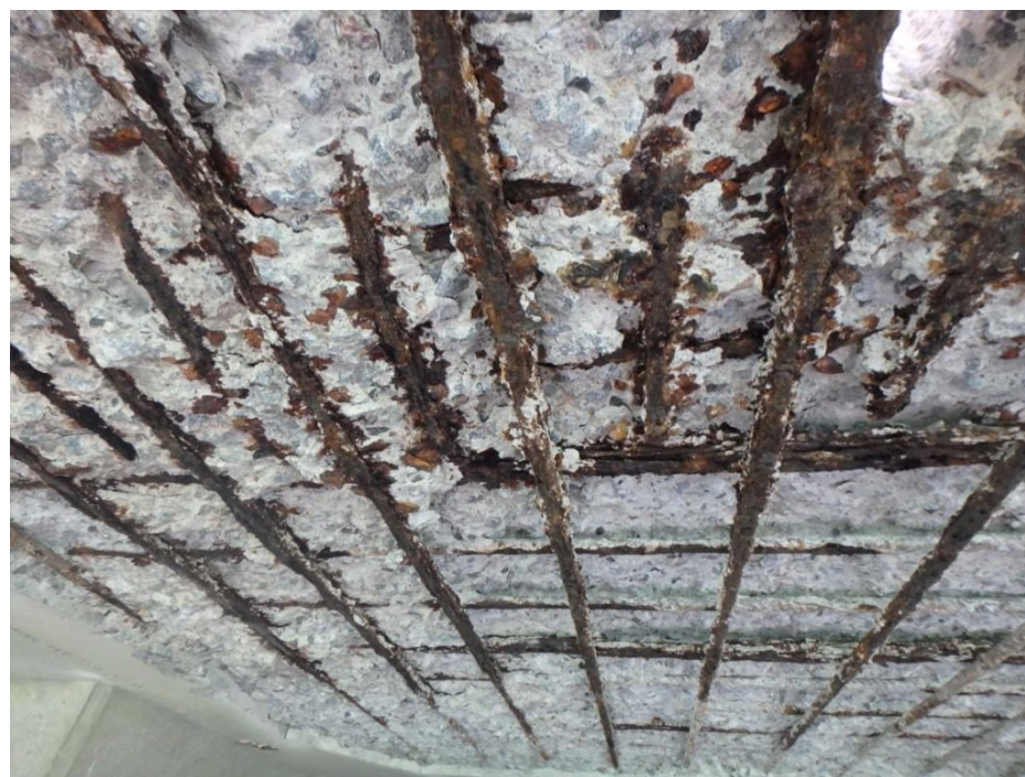
Korroderet og gennemtæret armering på US brodæk.
