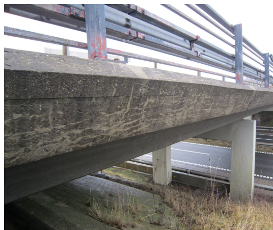
Kantbjælke. Karakteristiske langsgående revner. (Foto: Ricardo Barbosa)
