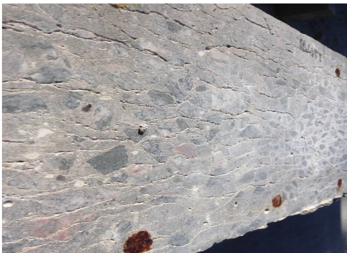
Brodæk skæreflade – Indre karakteristiske langsgående revner. (Foto: Ricardo Barbosa)
