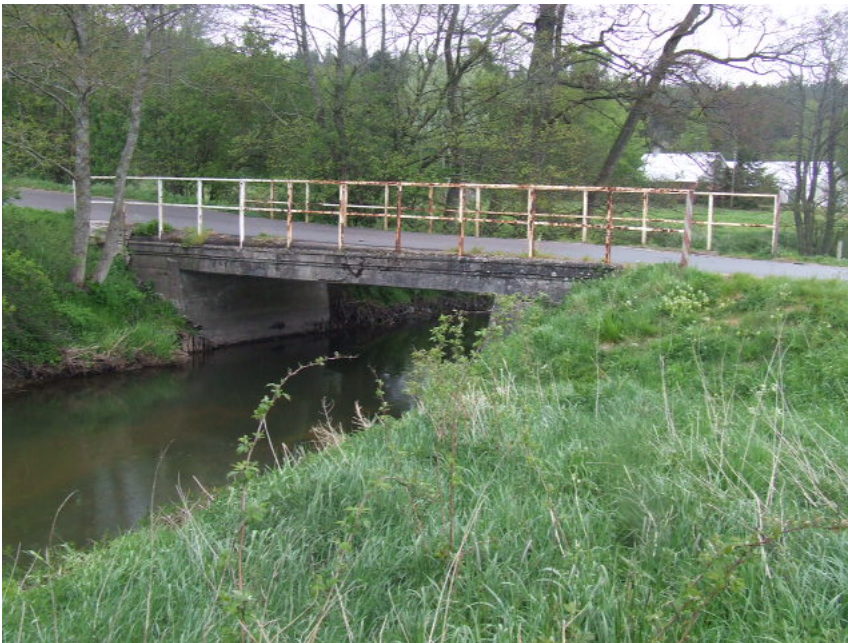
Rækværk udskiftes normalt, da det eks. er udtjent, og ikke lever op til de nye normer
