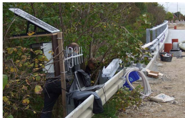
Afprøvning af "billigt" on-line monitoringsystem
