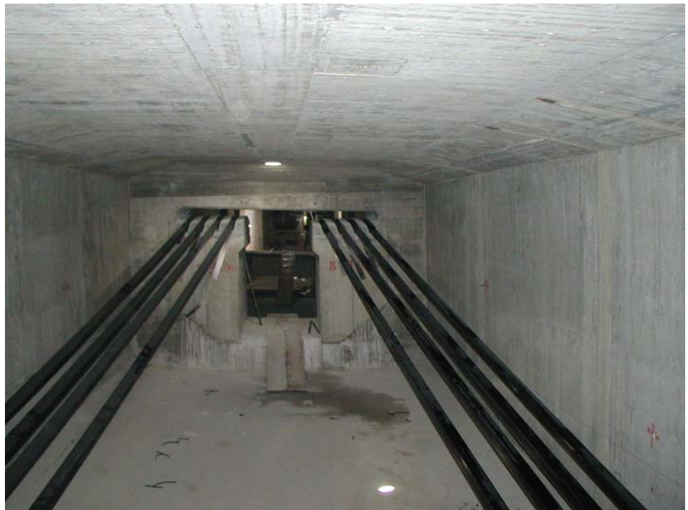
"Ekstern forspænding" – kassebro (forstærkning). Østrig.
